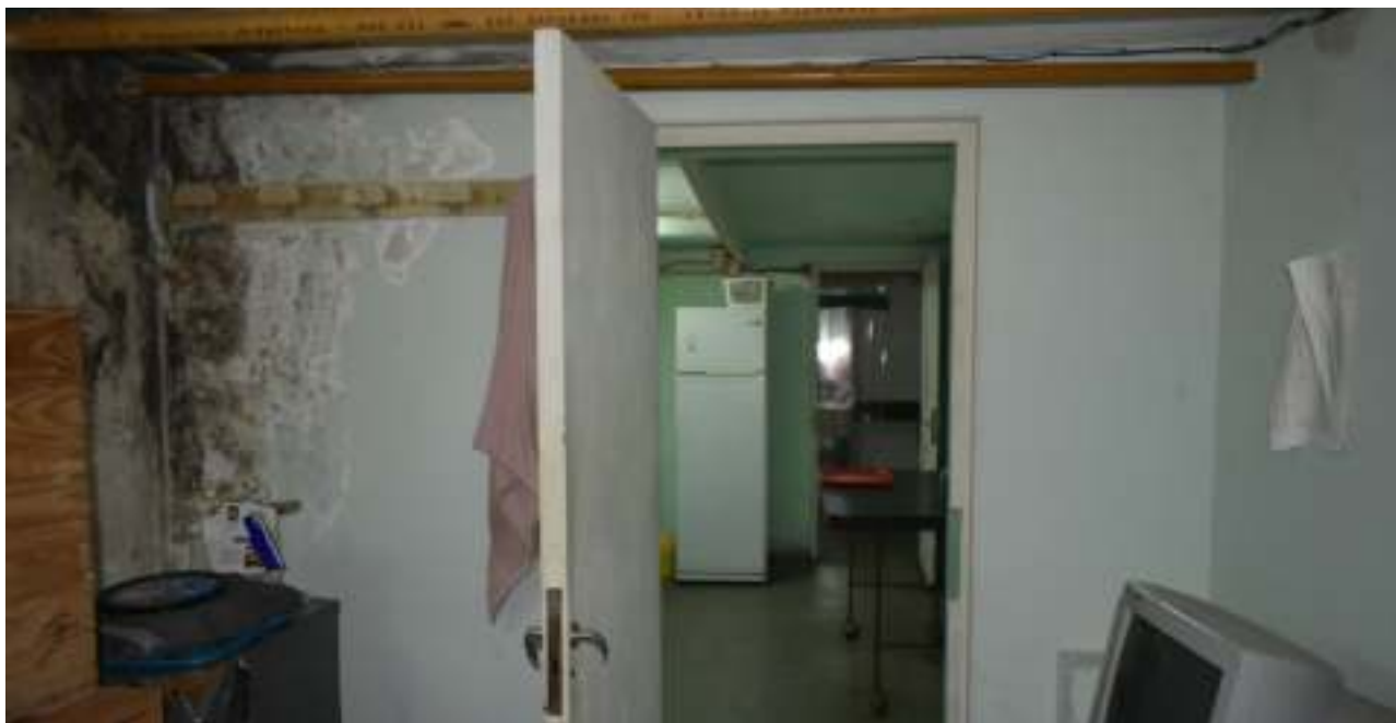
Sala donde se prepara la medicación. Pérdida de aguas servidas. Hospital Cullen.
