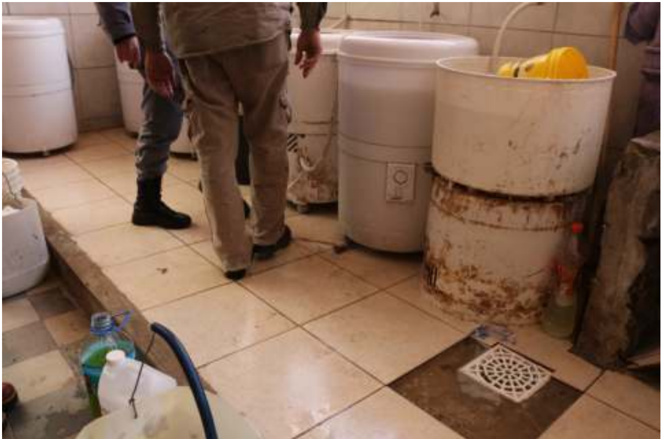
Sala de lavandería. Guardias escondiendo cables sobre piso mojado. Unidad IV
