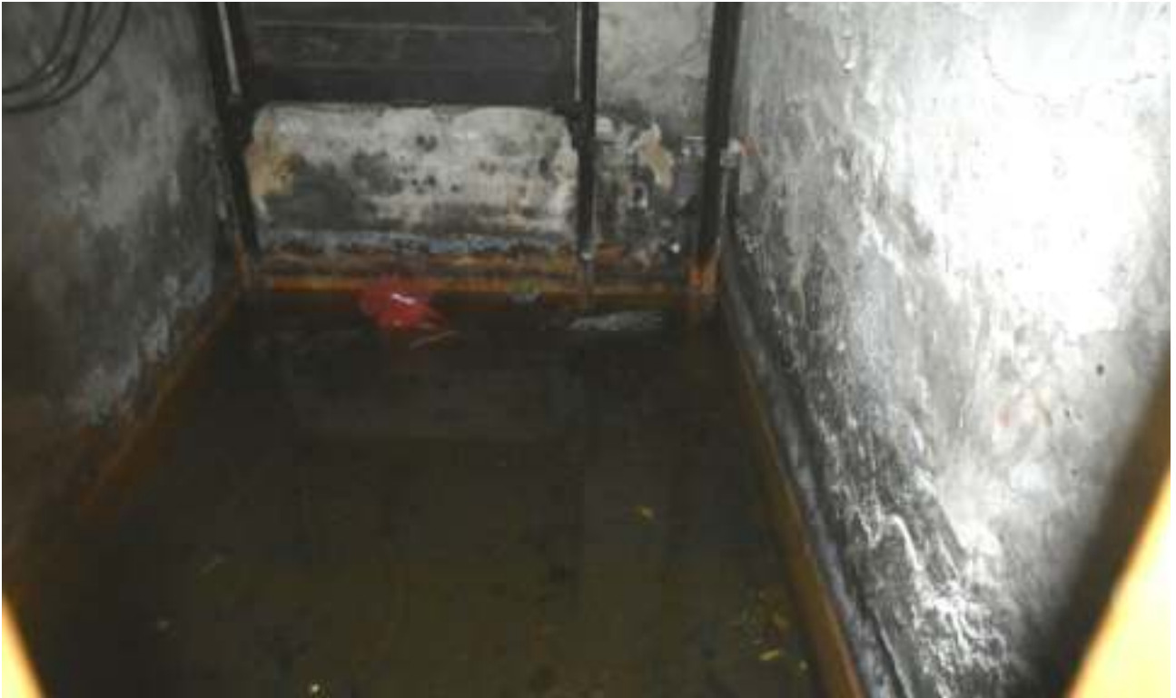
Hospital J. M. Cullen. Sala Penitenciaria. Ascensor inundado.
