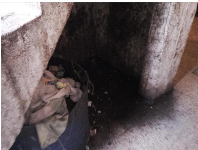
Foto Basura en estado de putrefacción depositada (escondida) bajo las escaleras que conducen a la celda de visitas íntimas - Alcaidía Melincué
